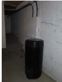
Nyere 200 liters varmtvannsbereder samt samleskap for trykksatte rørføringer på deler av anlegget.
