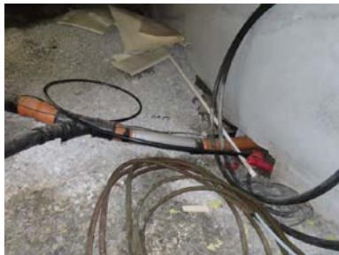
Jordingsmuffe på avløpsrøret (Stålrør med jordingskabel i kobber).
