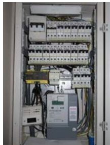
Sikringsskap med automater fra byggeår.
