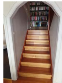
Del av repostrapp mellom 1 og 2.etg. Det ses å mangle håndløpere på vegg.
