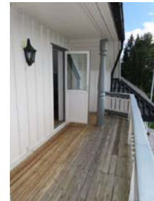
Del av veranda i 2.etg ut for stue/soverom etter nedre side. Dør fra stue - adkomst videre til terreng. Merk lavere rekkverk i forhold til dagens krav.
