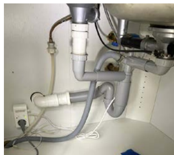
Avløpsrør i plast under kjøkkenvask
