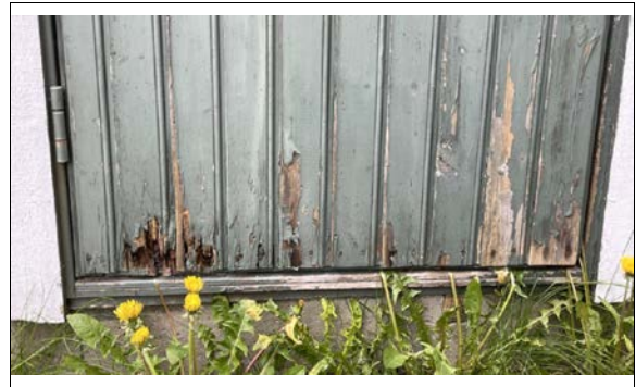
Råteskadet dør på utebod
