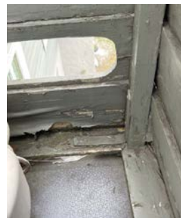
Begynnende råte og malingsslitasje på treverk.
