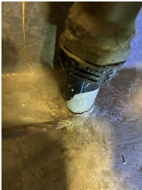
Glipper rundt rørgjennomføring.
