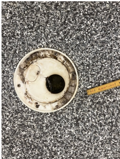
Mindre luftlommer under vinyl belegg rundt sluk.
