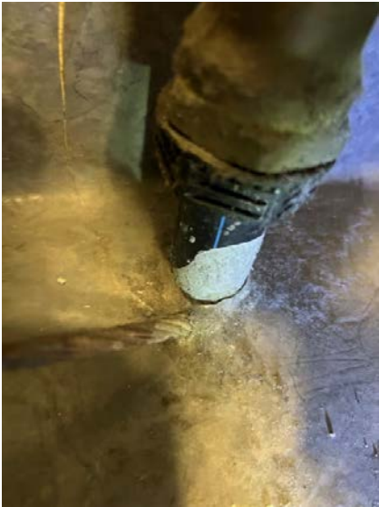
Glipper rundt rørgjennomføring.
