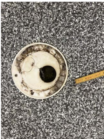
Mindre luftlommer under vinyl belegget rundt sluk.
