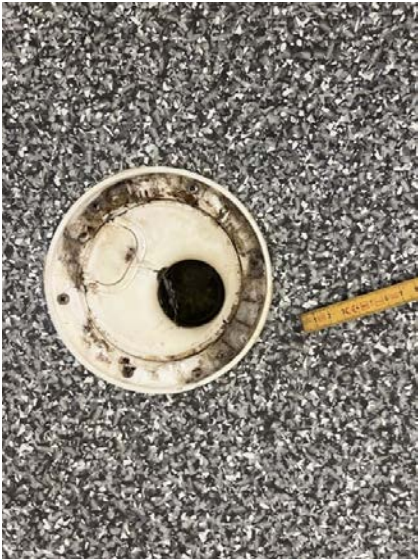
Mindre luftlommer under vinyl belegg rundt sluk.
