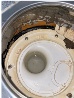
Manglende membran i sluk/gjennomføring
