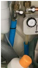
Manglende tettemuffer i enden på rør i rør.
