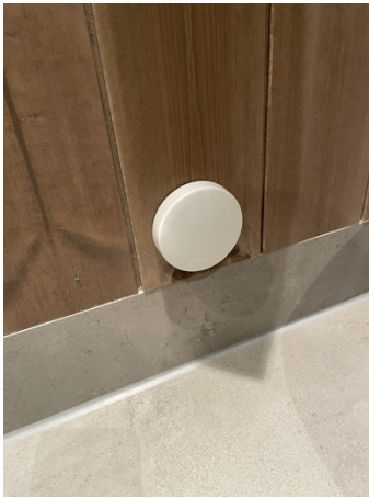
Drenering fra rørfordelerskap.
