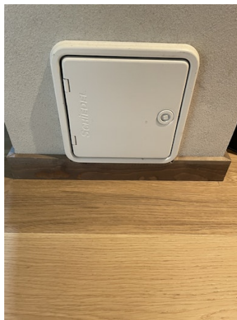
Manglende ubrennbar plate foran feieluke.
