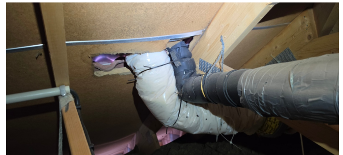
Utett rør gjennomføring i undertak
