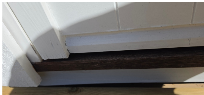
Sprekker og svelling nedkant dør
