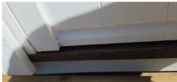
Sprekker og svelling nedkant dør
