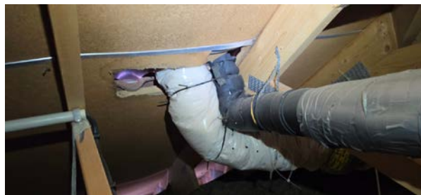
Utett rør gjennomføring i undertak
