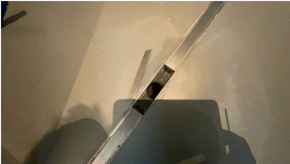
Sluk i gulv.
