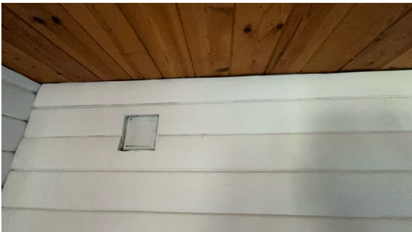
Eksempel på montert ventil i vegg.
