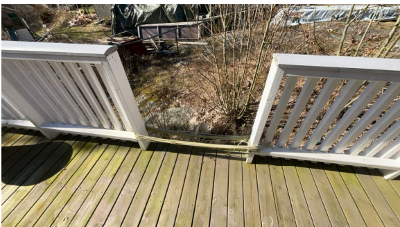
Område det mangler rekkverk.
