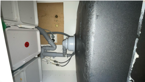
Del av rør til avløp.
