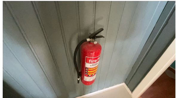
Brannslukningsapparat i underetasje.
