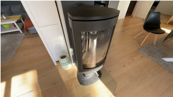
Montert ovn i stue.
