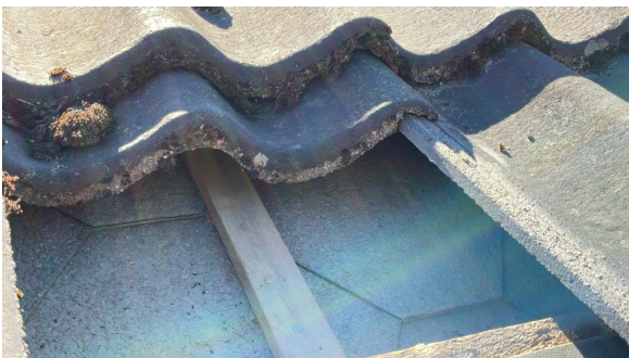
Del av takteking. Takstein er flyttet på.
