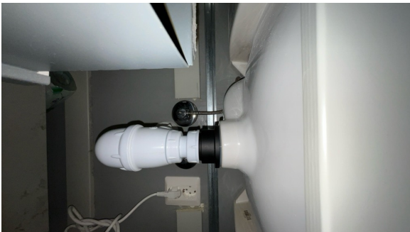
Del av rør til vann.
