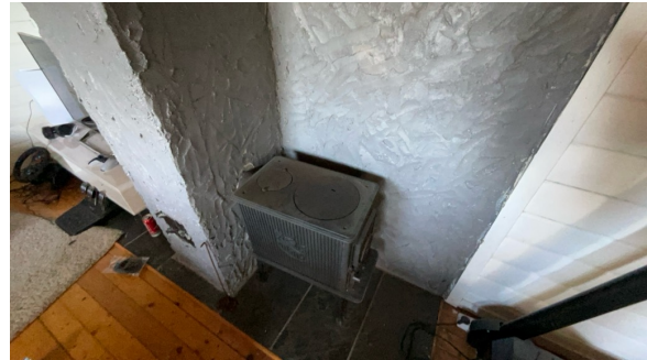
Montert ovn i stue.
