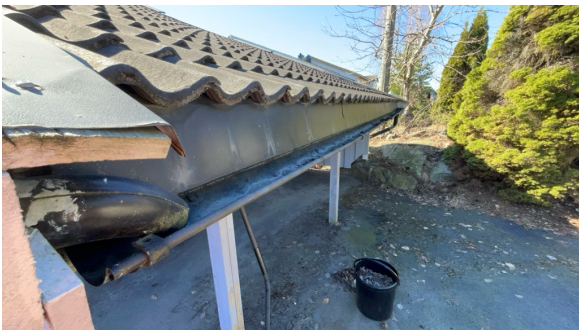
Renne med deformasjon.
