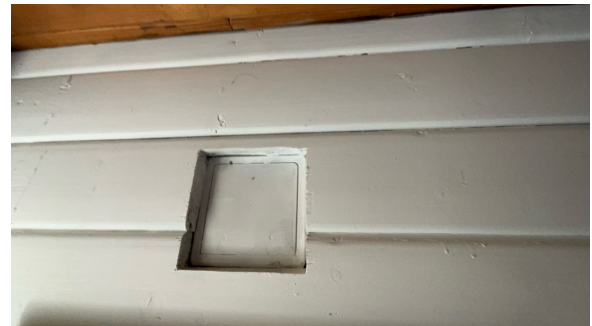
Eksempel på montert ventil i vegg.
