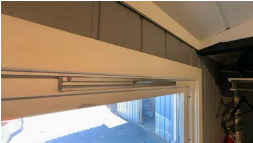
Eksempel på montert ventil i vindu.
