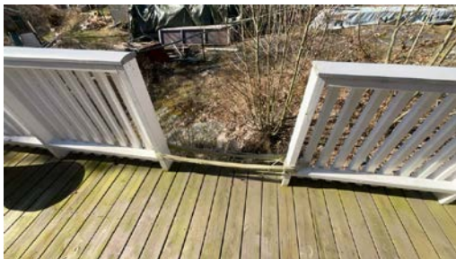
Område det mangler rekkverk.
