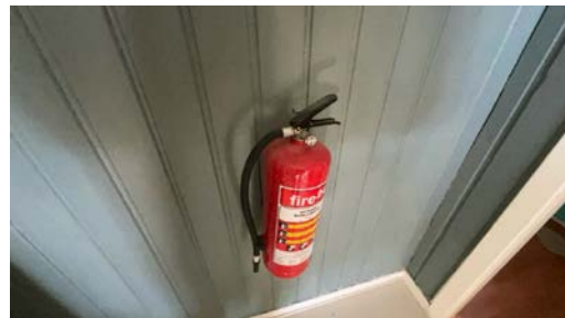
Brannslukningsapparat i underetasje.
