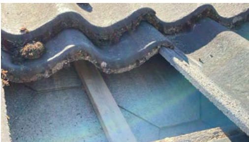
Del av taktekkning. Takstein er flyttet på.
