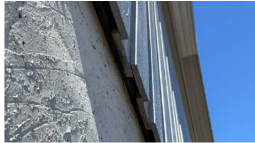
Det er ingen eller liten lufting i nedre kant av kledning mot grunnmur.
