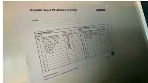
Kursfortegnelse i skap til rør i rør systemet.
