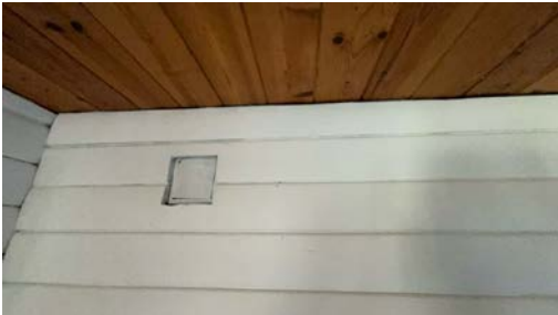
Eksempel på montert ventil i vegg.
