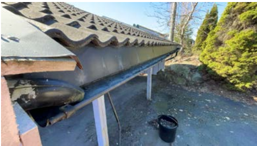
Renne med deformasjon.
