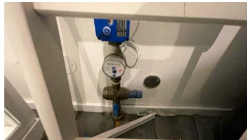
Stoppekran til vann.
