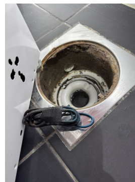
Løs jordingskabel som ikke er festet til slukristen.
