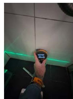
Fuktsøk i overflaten i dusjsjonen.
