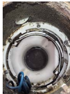
Hovedsluket er plassert under vaskemaskinen.
