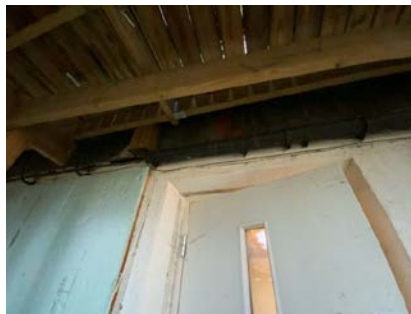
Kontroll av membran og overganger. Endeblick bør opparbeides med takrenne.
