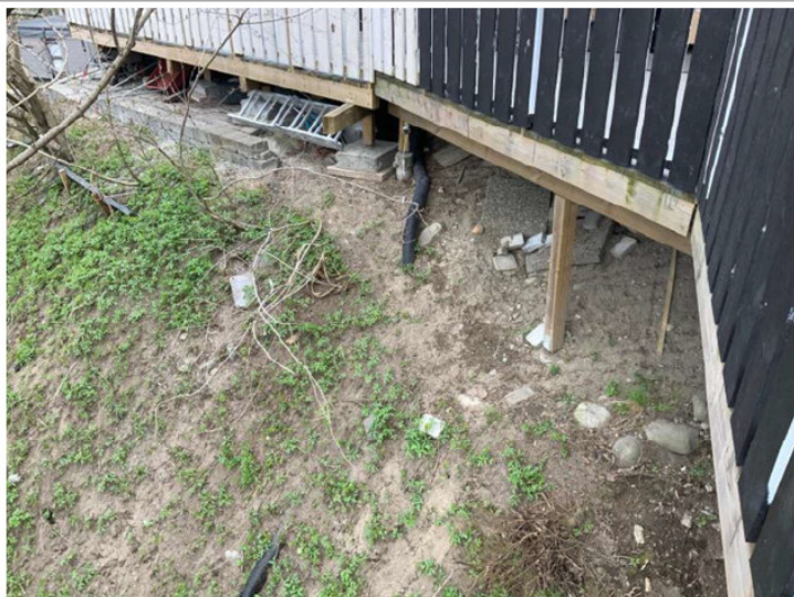
Mot sør Pilarer for terrasse. Skjevheter oppstått i disse.
