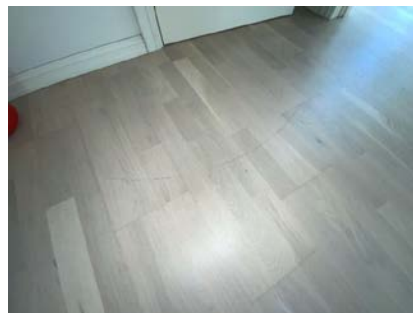
Synlige avvik på overflater.
