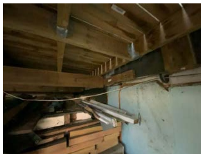
Forankringer mot vegg bør utbedres.
