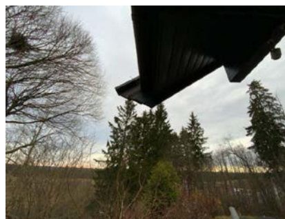
Vindskier har behov for vedlikehold evt. utskiftinger påsikt
