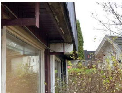
Grunnmuren har sprekkdannelser.
