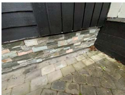
Løs fasadestein. Lokal utbedringer bør utføres.
