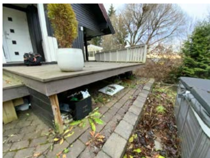
Manglende rekkverk i front.
