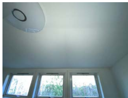
Synlige avvik på overflater.
