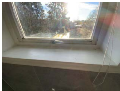
Kondensskader på karmen.
