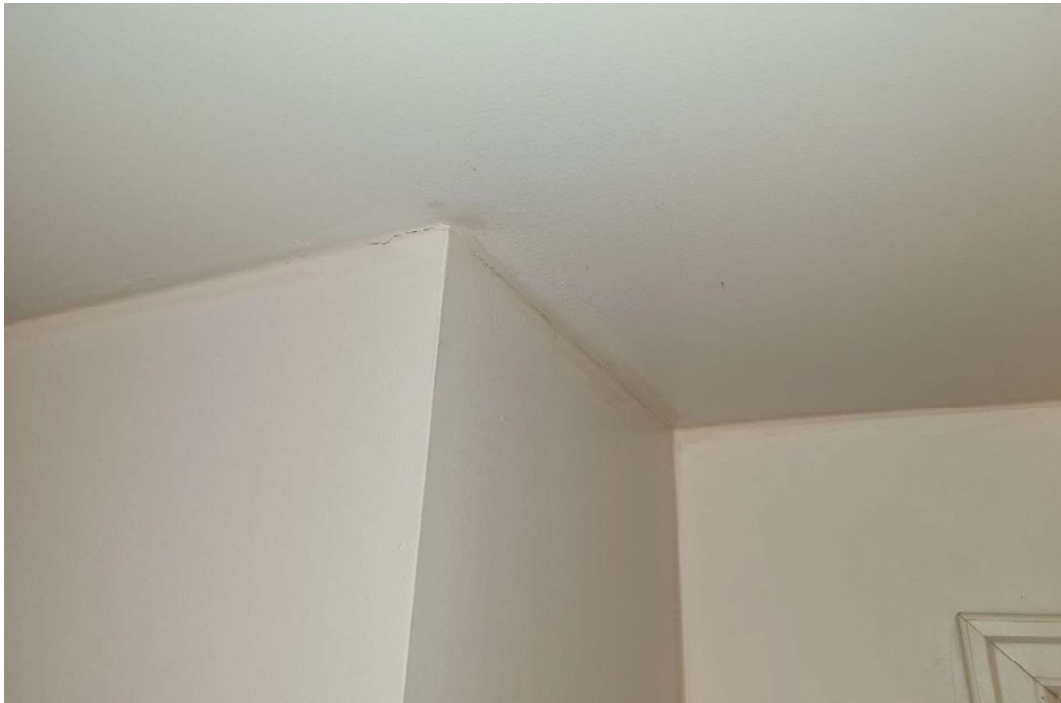
Bilde 6 – viser riss i gipsede himlinger fremstår som spenninger og dårlig håndverk.
