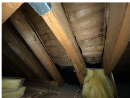
Noe missfarget undertak.
