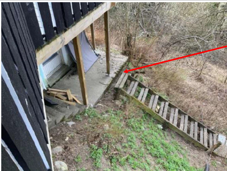
Trapper i terreng har beveget seg ut fra tilslutning i topp (pil)
