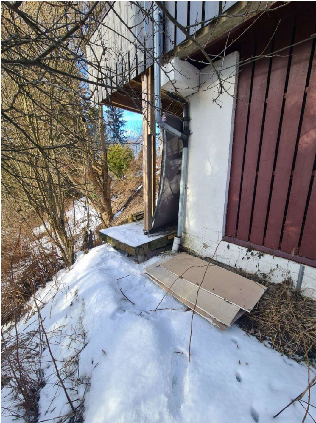
Bilde 3 – viser trapp med søyler på den mest utsatte siden.
