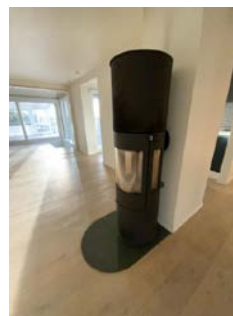
Besiktigelse av ildsted. Pipeløp er bekledd med plater.
