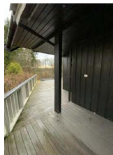
Bærende stolpe er noe skjev og bør rettes opp.
