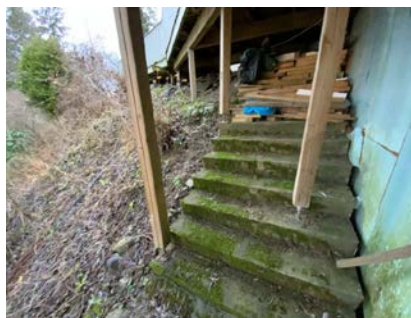
Synlige skjevheter på fundamenter.
