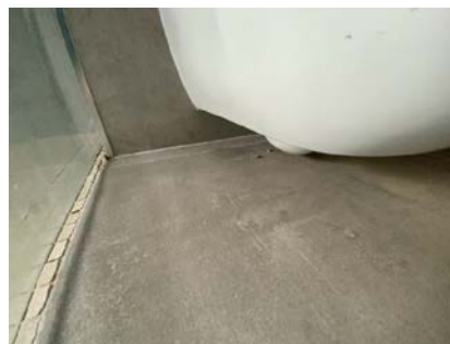
Lekkasjespalte på innebygget sisterner bør opparbeides.
