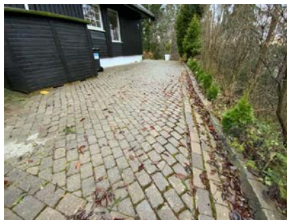
Grunn har vært i bevegelser over tid men ansees som stabilt på befaringdagen.
