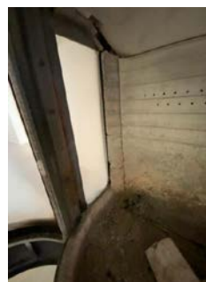
Synlige sprekkdannelser på ildplater inne i ovn.
