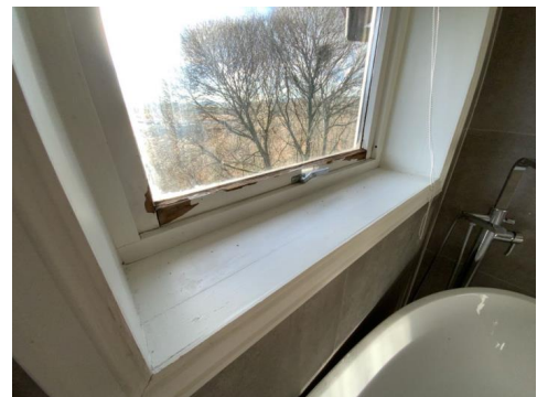
Kondensskader på karmen.
