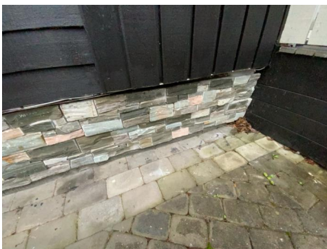
Løs fasadestein. Lokal utbedringer bør utføres.
