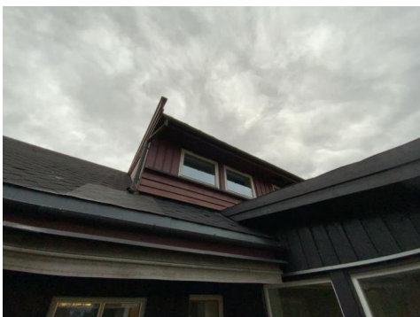
Panel på oppløft med synlig elde. Kommende overflatebehandling eller utskiftinger på sikt er påregnelig.
