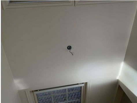
Stedvis løse ledninger som kan være strømførende.
