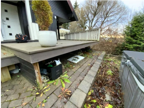
Manglende rekkverk i front.
