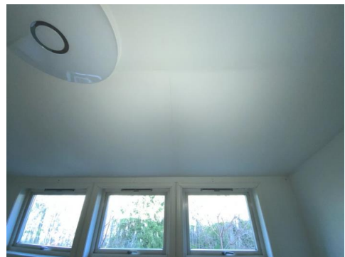
Synlige avvik på overflater.
