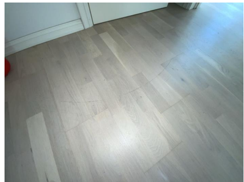
Synlige avvik på overflater.
