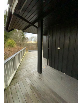
Bærende stolpe er noe skjev og bør rettes opp.
