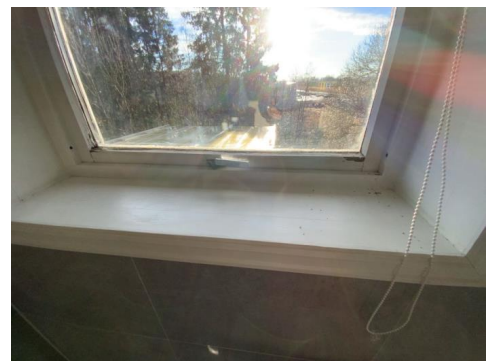
Kondensskader på karmen.
