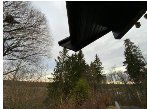
Vindskier har behov for vedlikehold evt. utskiftinger påsikt
