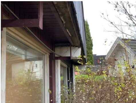
Grunnmuren har sprekkdannelser.
