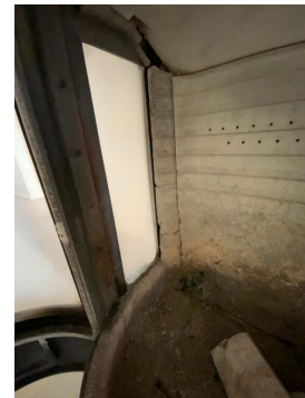
Synlige sprekkdannelser på ildplater inne i ovn.
