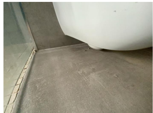
Lekkasjespalte på innebygget sistene bør opparbeides.
