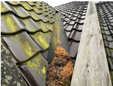
Lekkasjer ved gradrenner
