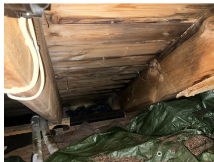
Fukt i undertaket og sperrer
