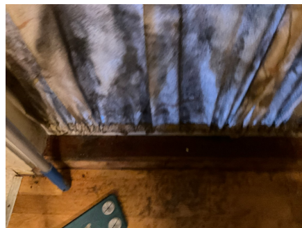
Mugg på overflatene etter vannlekkasjen.
