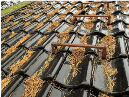
Rust på beslag og takstige
