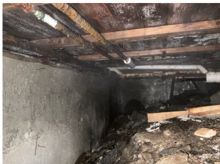
Drypper fra etasjeskille
