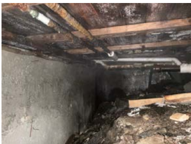
Drypper fra etasjeskille
