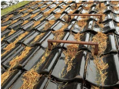
Rust på beslag og takstige
