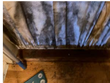
Mugg på overflatene etter vannlekkasjen.
