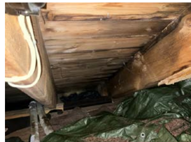
Fukt i undertaket og sperrer
