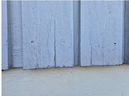
Råte i bunn av kledningsbord.
