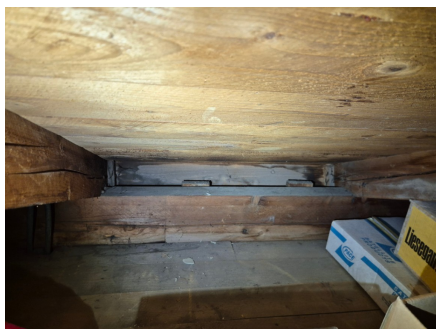
Ingen lufting i nedre del mot raft.
