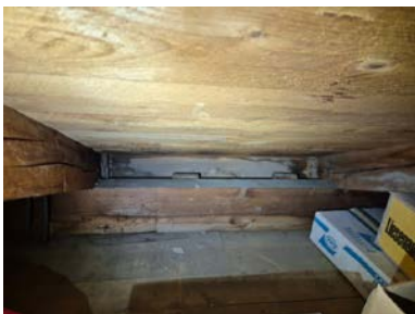
Ingen lufting i nedre del mot raft.
