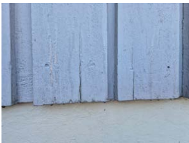
Råte i bunn av kledningsbord.
