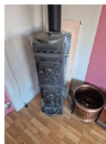
Mangler ubrennbar plate på gulv i front av ovn.
