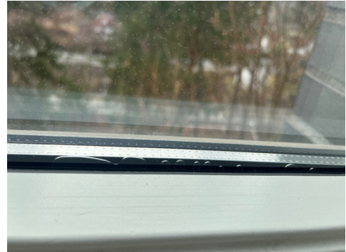
Tegn på delaminering av glass
