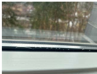
Tegn på delaminering av glass
