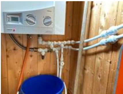
Oppvarming av vann
