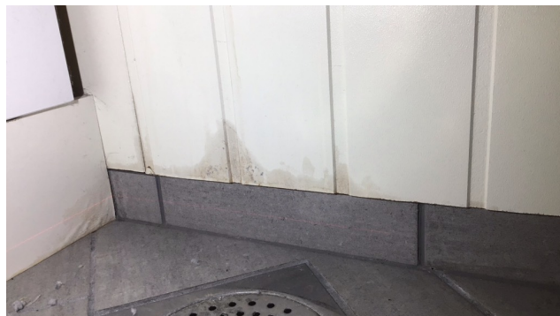
fukt skader i nedkant panel
