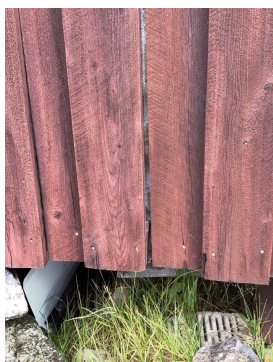
Viser åpninger mellom kledningsbordene.
