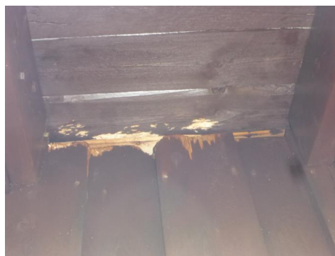
Viser klore-/gnagemerker under takutstikk etter skadedyr.
