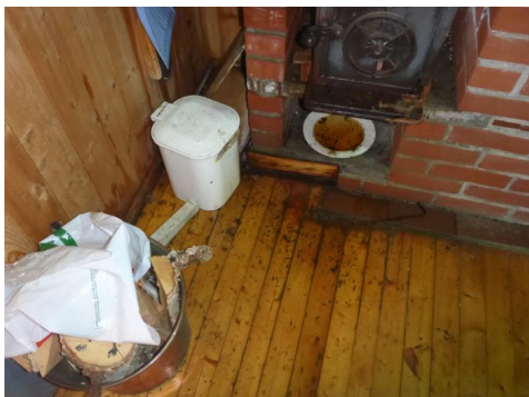
Viser frittstående vann på gulvet i kjøkkenet på befaringdagen.
