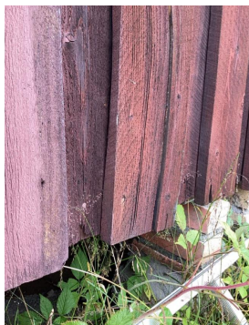
Viser kledning som er oppsprekt og værslitt.
