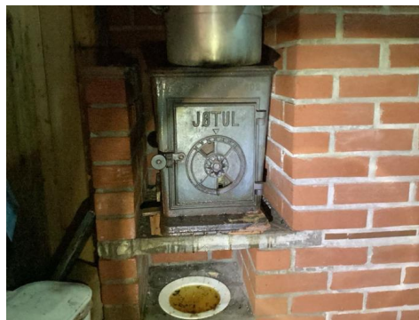
Viser vedovn som ikke er montert etter anvisning.
