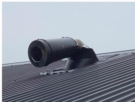
Viser stålpipe knekt over tak.
