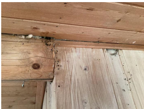
Viser spor etter mus i takkonstruksjon.
