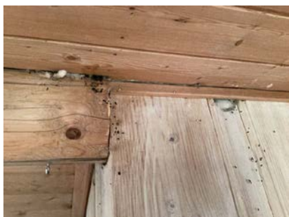
Viser spor etter mus i takkonstruksjon.
