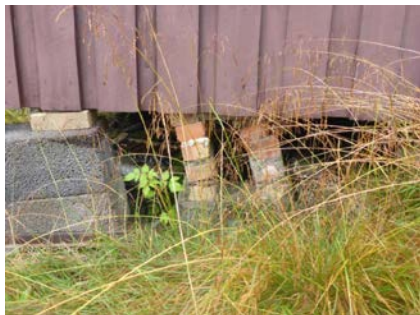
Viser pilarer med setninger/skjevheter.
