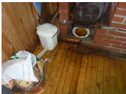
Viser frittstående vann på gulvet i kjøkkenet på befaringsdagen.
