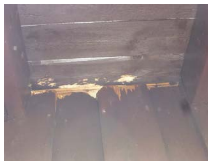
Viser klore-/gnagemerker under takutstikk etter skadedyr.
