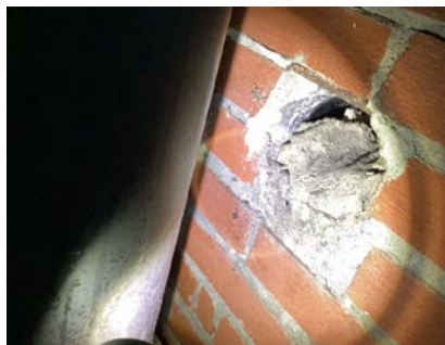
Viser ufullstendig gjennommurt pipe.
