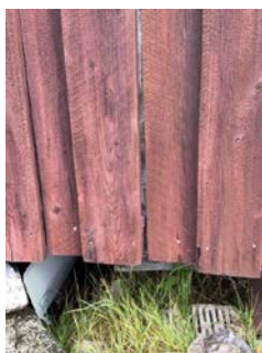
Viser åpninger mellom kledningsbordene.
