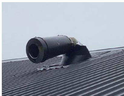
Viser stålpipes knekt over tak.
