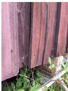
Viser kledning som er oppsprekt og værslitt.
