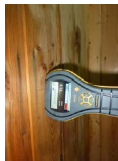
Viser fuktmåling i skillevegg mellom kjøkken og stue med høye verdier av fukt.
