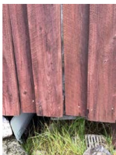
Viser åpninger mellom kledningsbordene.
