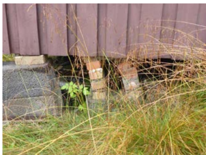
Viser pilarer med setninger/skjevheter.
