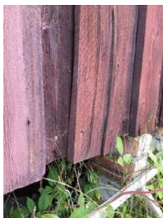
Viser kledning som er oppsprekt og værslitt.
