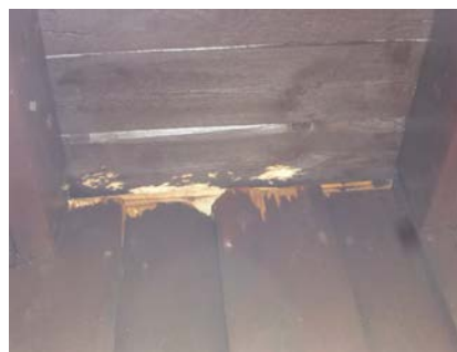
Viser klore-/gnagemerker under takutstikk etter skadedyr.
