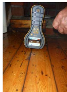
Viser fuktmåling i gulv på kjøkken med høye verdier av fukt.
