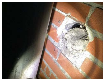
Viser ufullstendig gjennommurt pipe.
