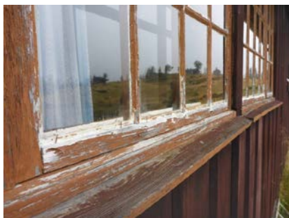
Viser vindu med manglende kitt og stor værslitasje.
