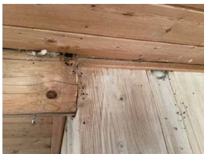
Viser spor etter mus i takkonstruksjon.
