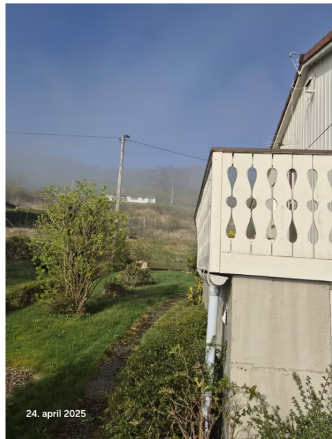
Bildet viser rekkeverk som er løst, og henger utover.
