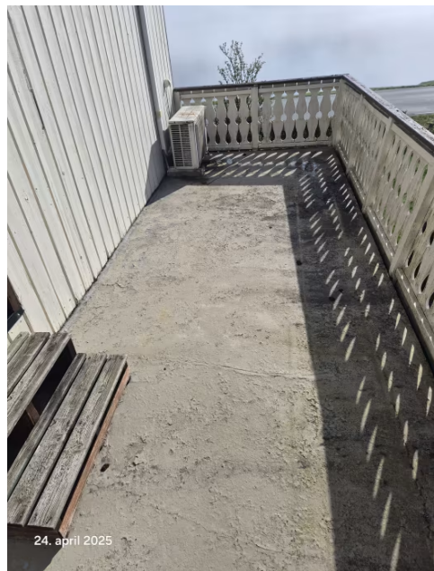
Bildet viser platting som trenger vedlikehold, samt innside av rekkeverk som har råteskader ved innfestning.
