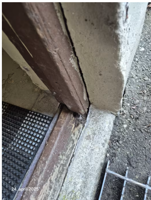
Terskel på dør inn til vaskekjeller har råteskader.
