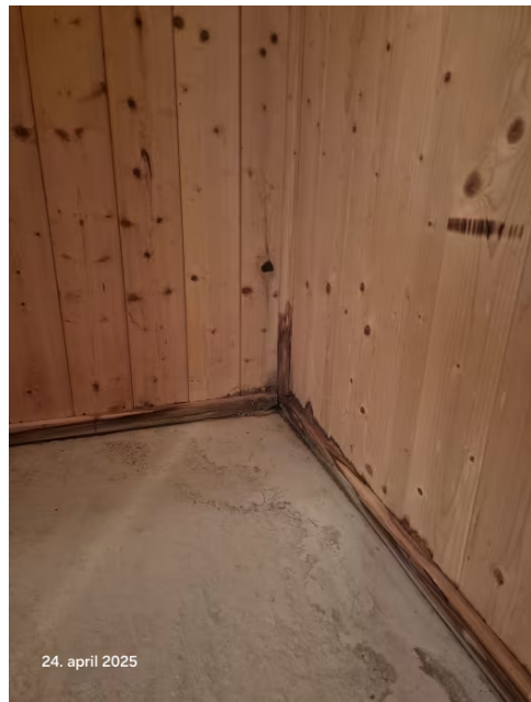
Sort område på panelet markerer fukskade.
