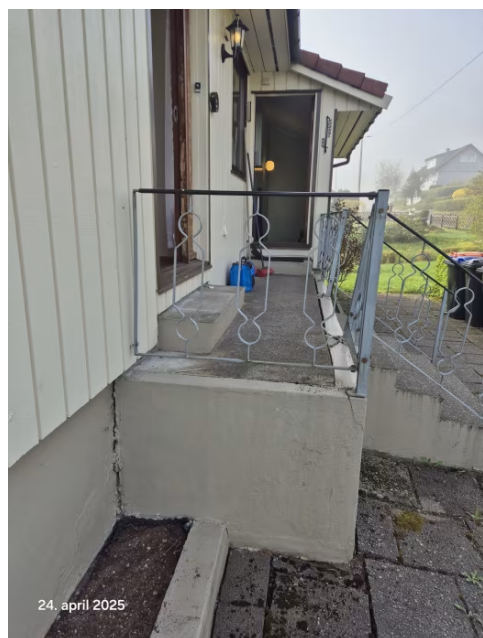
Plattingen som danner inngangspartiet, har setningsskader.
