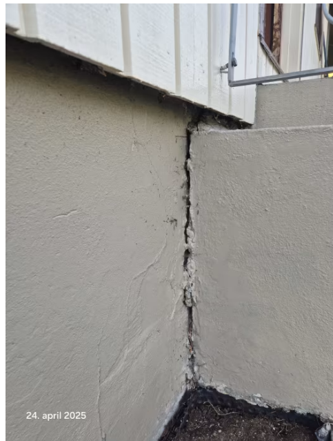
Skjøt som har løsnet.
