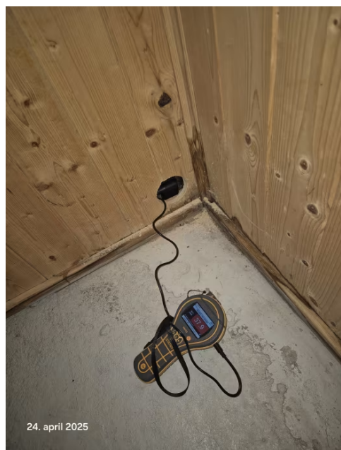
40% fuktighet registrert inne i utforet konstruksjon.
