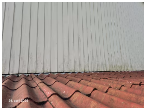
Grønske oppover kledningen.
