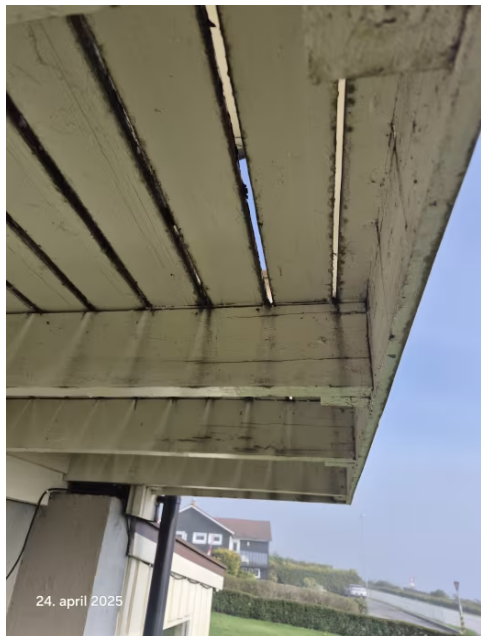
Underside av terrasse bærer preg av alderen.
