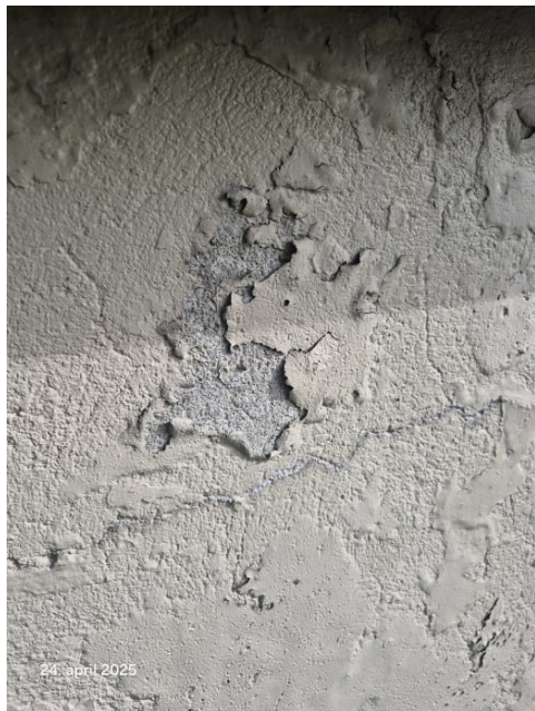
Avskallinger på mnrvegger finnes flere steder.
