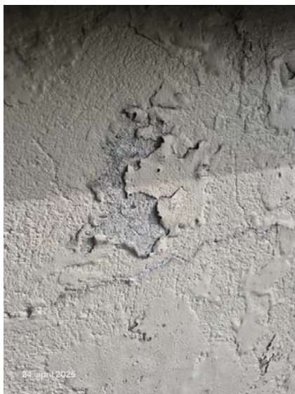
Avskallinger på mnrvegger finnes flere steder.
