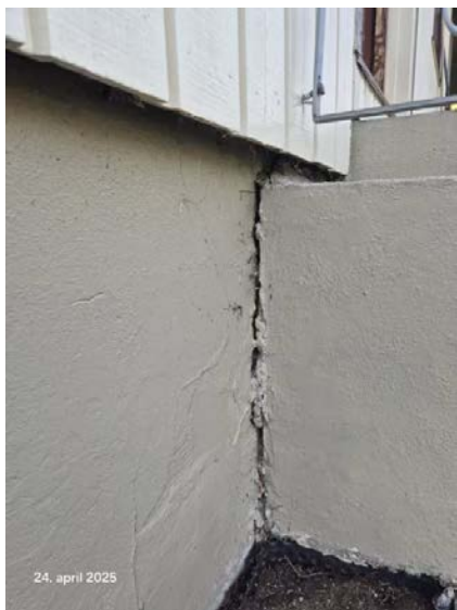
Skjøt som har løsnet.
