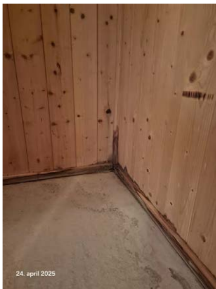
Sort område på panelet markerer fukskade.
