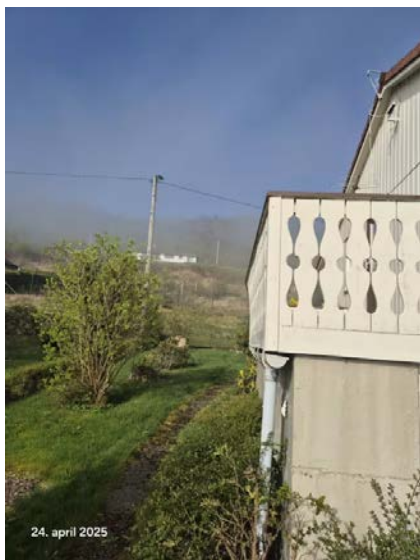
Bildet viser rekkverk som er løst, og henger utover.
