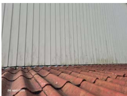
Grønske oppover kledningen.
