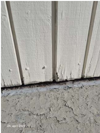
Kledning på terrassesiden er soltørket og værslitt.
