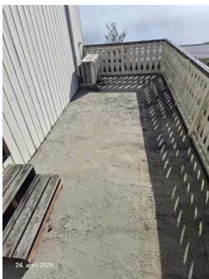
Bildet viser platting som trenger vedlikehold, samt innside av rekkverk som har råteskader ved innfestning.
