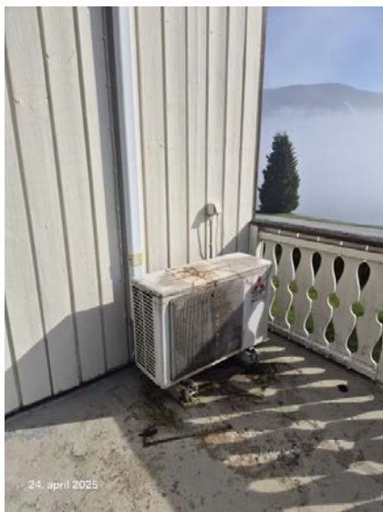
Utedelen til varmepumpa er værslitt.
