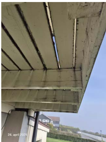
Underside av terrasse bærer preg av alderen.
