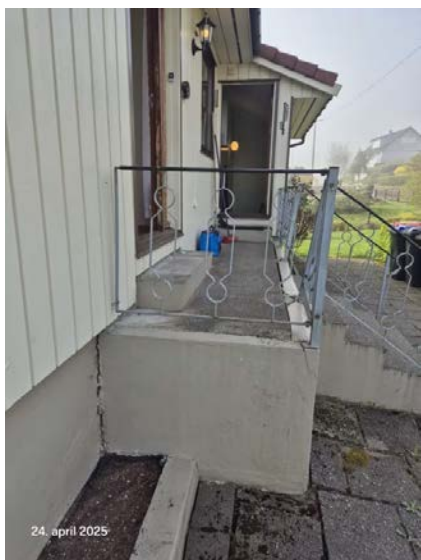
Plattingen som danner inngangspartiet, har setningsskader.
