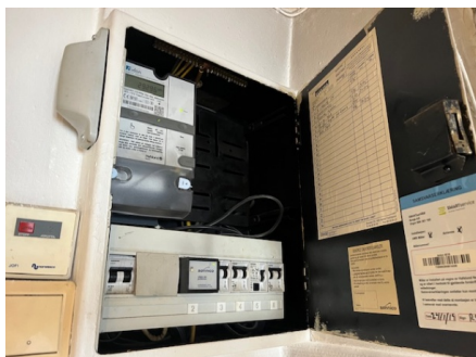
Sikringskap plassert i entre.
