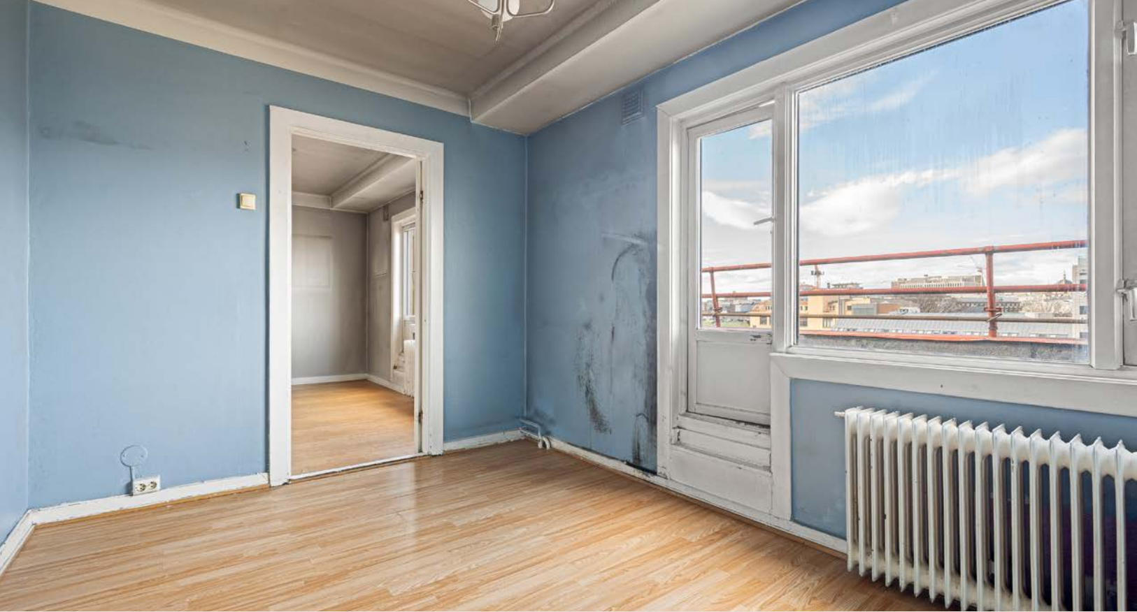
Overflater har behov for oppgradering for å kunne bo der.
