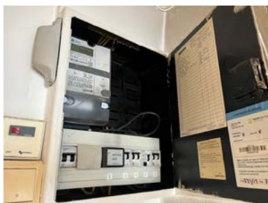
Sikringskap plassert i entre.
