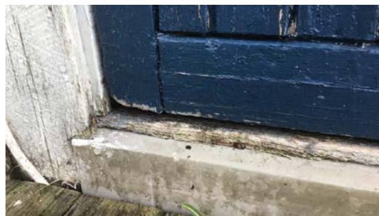
Råteskader i nedkant
