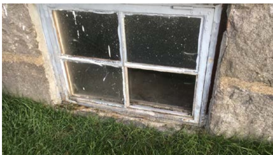
Råte i vinduskarmer
