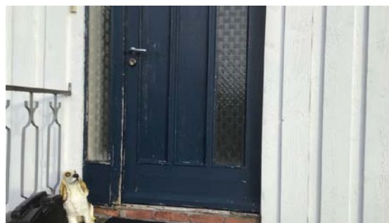
Inngangsdør mangler glass i dørblad
