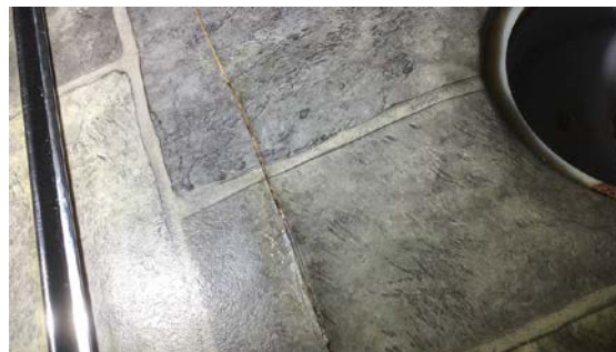
sprekker i belegget
