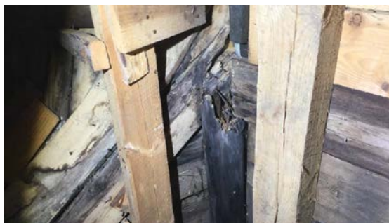
Eldre fukt/råte skade
