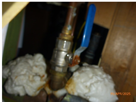
Synlig inn til nabo via luke i badevegg i kjeller
