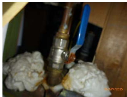
Synlig inn til nabo via luke i badevegg i kjeller
