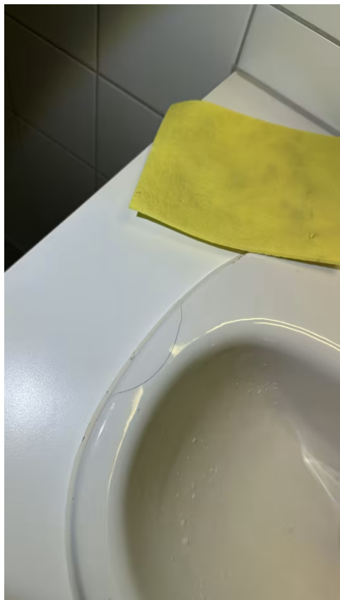
-Sprekk i servant.
