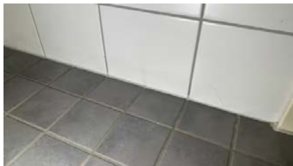
-Riss i fuge, sprekk i 3 fliser ved dør til gang. Tg:3. Estimert reparasjonskostnad ca. 10 000,- lft. plassering og konsekvens er det ikke umiddelbar behov for utbedring.
