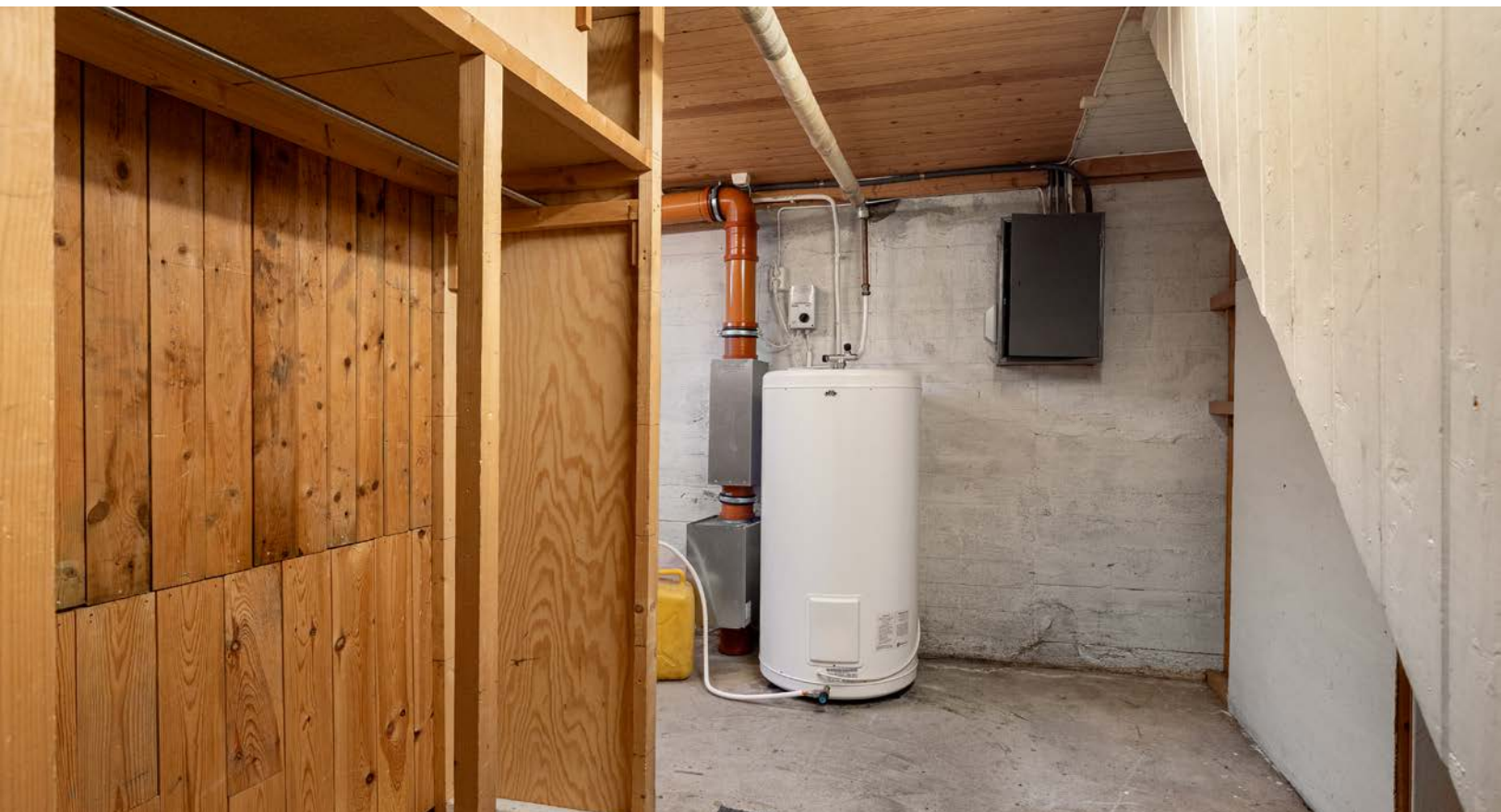
I kjellerboden finner du også varmtvannsberederen og sikringsskapet.
