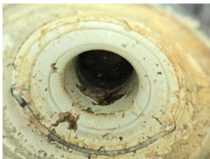
Bild av sluk under dusj.
