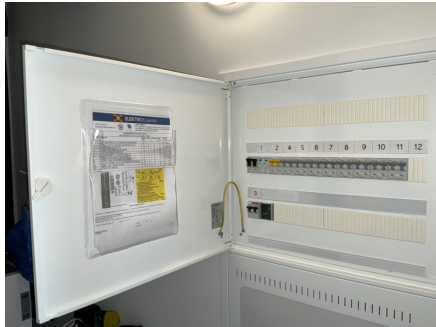
Automatsikringer i sikringskåp plassert i teknisk bod.
