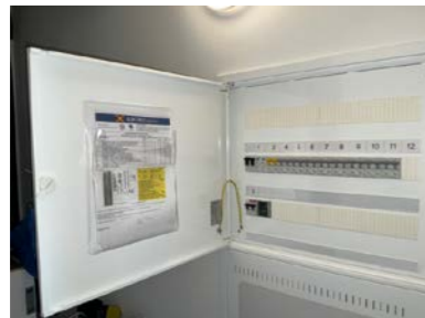
Automatsikringer i sikringskap plassert i teknisk bod.
