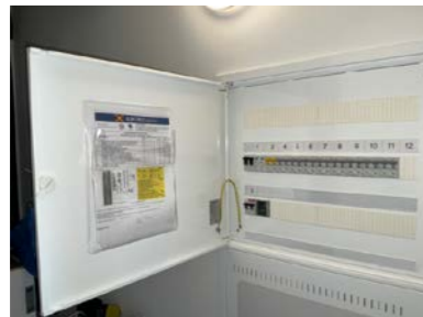
Automatsikringer i sikringskap plassert i teknisk bod.
