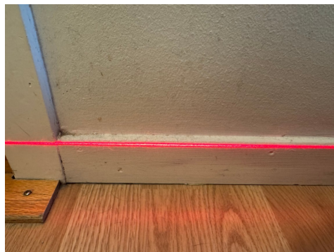
Bilder viser skjevheter i gulv i stue.
