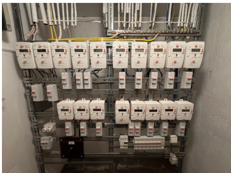
Felles målerskap i u-etg.
