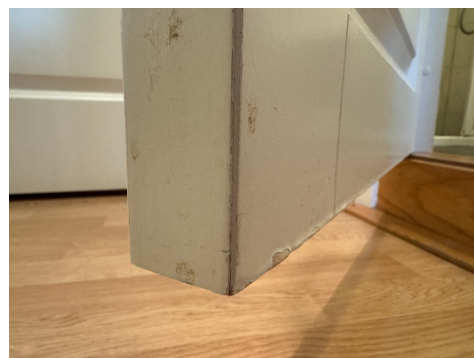
Fuktutsvelling/slitasje i nedre del av badedør.
