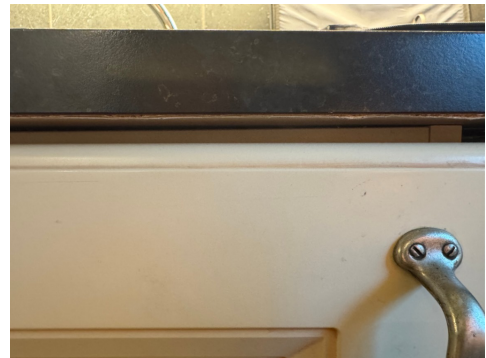
Fuktutsvelling på underside av benkeplate.
