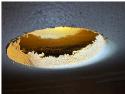
Fuktskade i nedre del av vegg (synlig v/ hulltaking).
