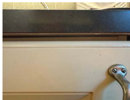
Fuktutsvelling på underside av benkeplate.
