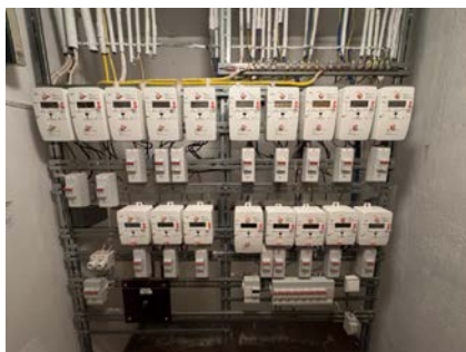
Felles målerskap i u-etg.
