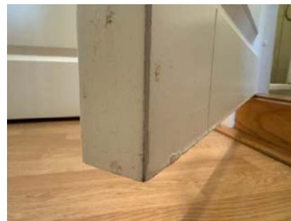
Fuktutsvelling/slitasje i nedre del av badedør.
