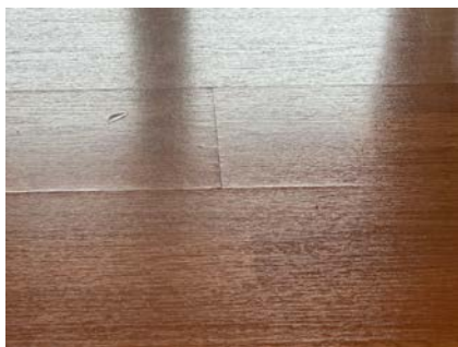
Fuktutsvelling i laminatskjøter og sår/merke.
