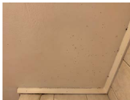
Soppdannelse i himling som følge av at el.avtrekksventil har liten/ingen effekt.
