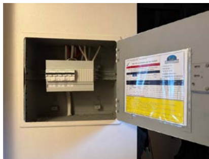
Sikringsskap i entre.
