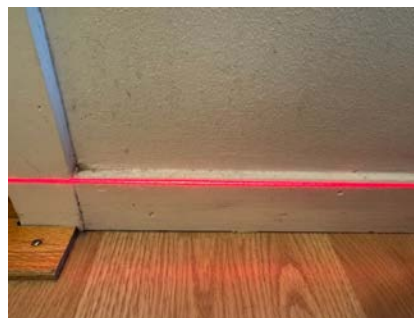
Bilder viser skjevheter i gulv i stue.
