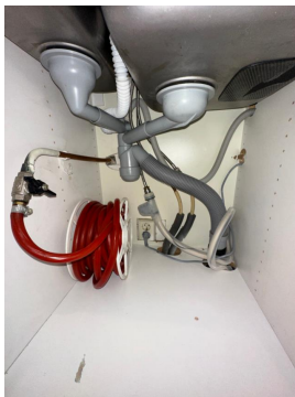
Rørpropplegg i kjøkkenbenk med brannslange
