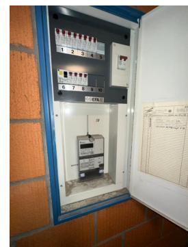
Sikringsskap med automatsikringer.
