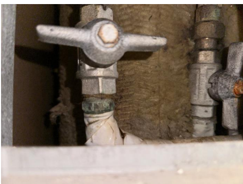
Stoppekraner plassert på bad
