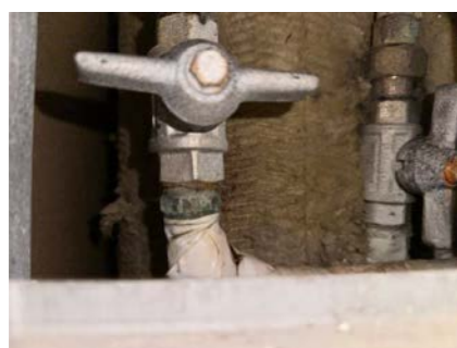
Stoppekraner plassert på bad
