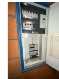
Sikringsskap med automatsikringer.
