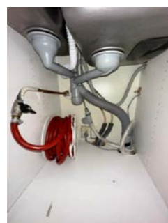
Røropplegg i kjøkkenbenk med brannslange
