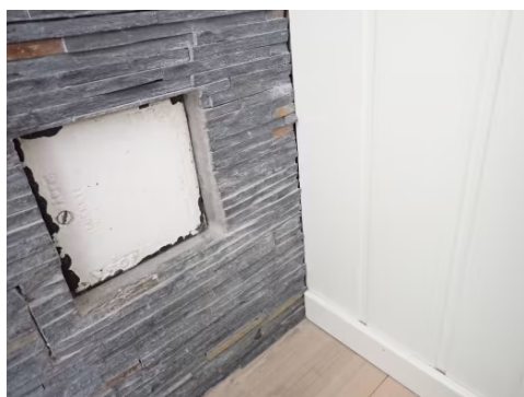
Mindre enn 30 cm ut fra luka mot brennbart materiale på vegg
