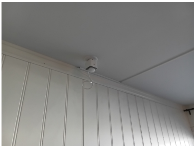
Stikkontakt i hjørne stue mot yttervegg veranda. Jordet stikkontakt mangler jordforbindelse. Samt løs kabel.
