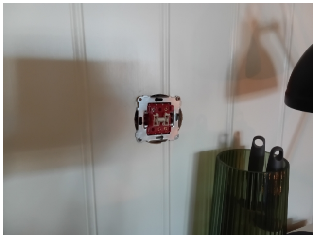
4- veis stikkontakt på vegg for flatskjerm og div. i stue. Mangler jordforbindelse.
