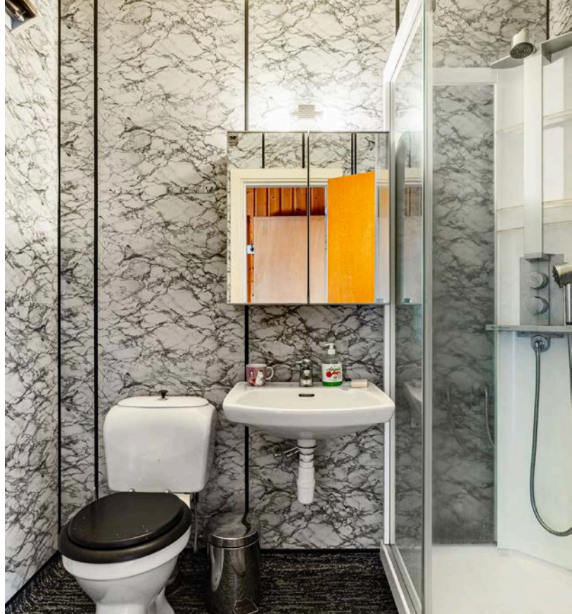
Det andre baderommet i 2. etasje må oppgraderes for å tåle normal bruk etter dagens krav.
