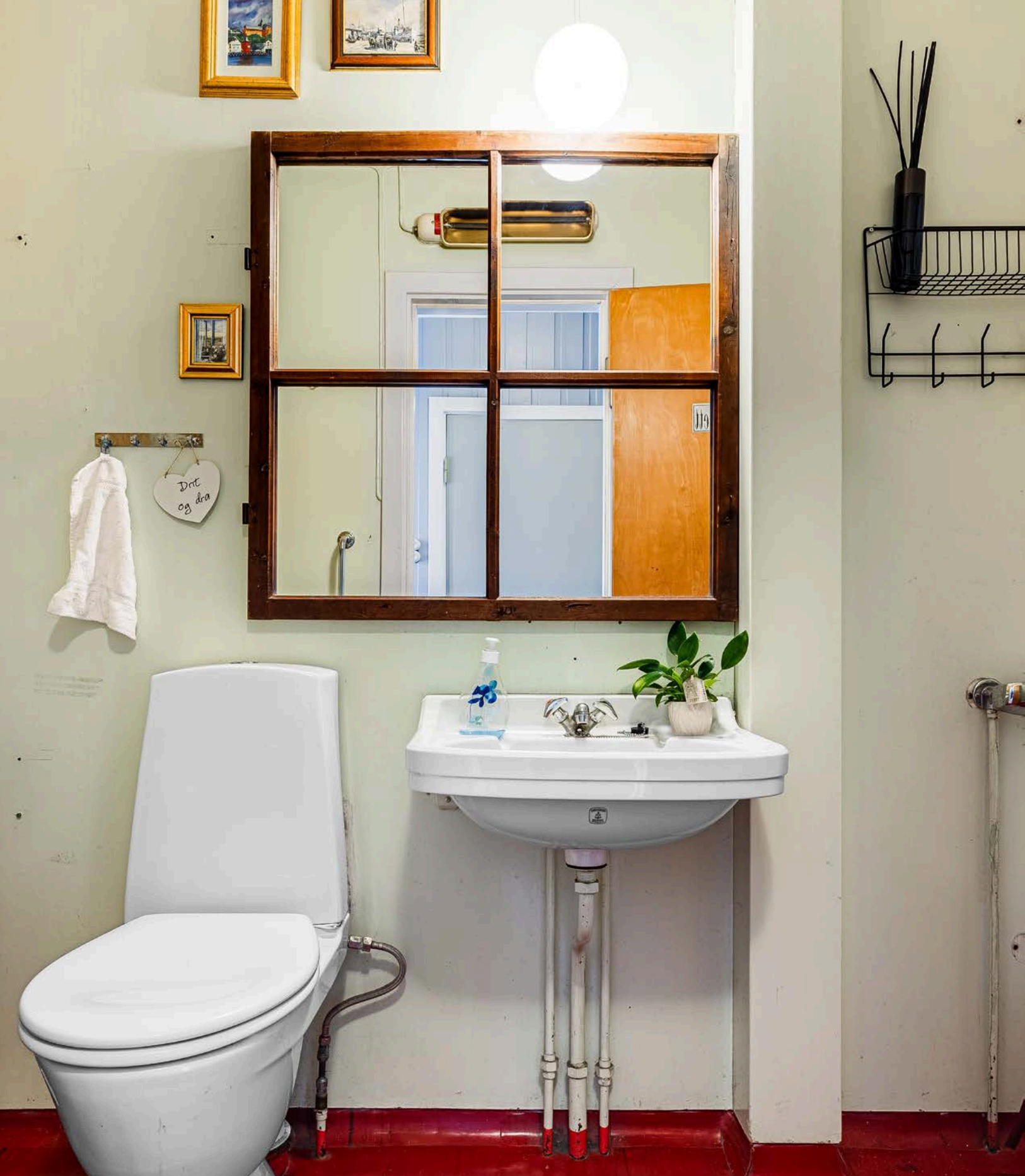
Toalettrom i 1.etasje, tidligere badkamer. Toalettrom antas fra 1990 eller eldre. Gulv med vinylfliser, vegger og himling med malte plater.
