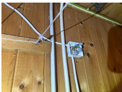
Koblingsboks må påmonteres deksel.
