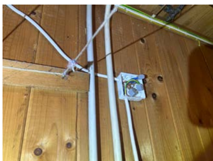
Koblingsboks må påmonteres deksel.
